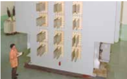
Rectifier 44.5 MVA - 15 kV, 115
